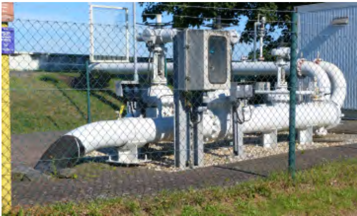
Abb. 7 Ventilgruppe und Molchstation am Ende der Sole-Pipeline (B), (Foto: N. Kück)
