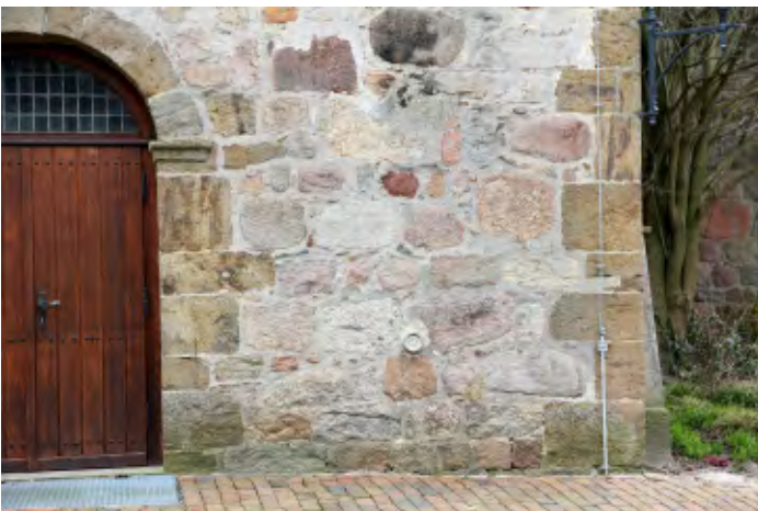
Abb. 4: Lage der Höhenmarke an der Westseite des Kirchturms, ca. 1,5 m neben der Tür in einer Höhe von knapp 80 cm über dem Boden. Foto: M. Klemke.
