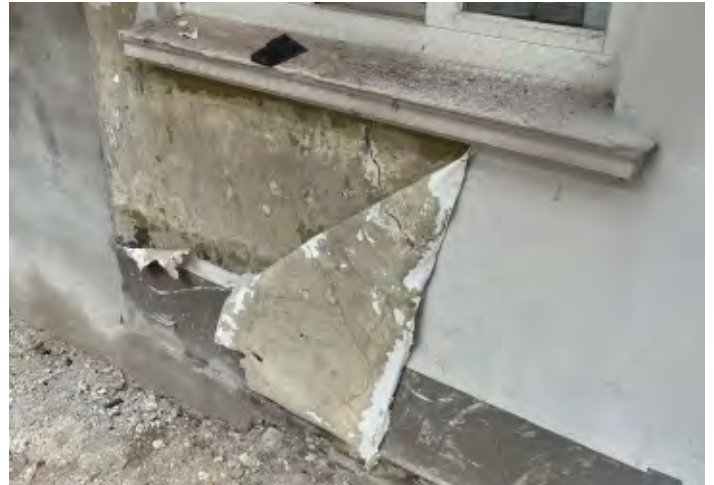
Ungeeigneter Untergrund für die neue Farbe.
