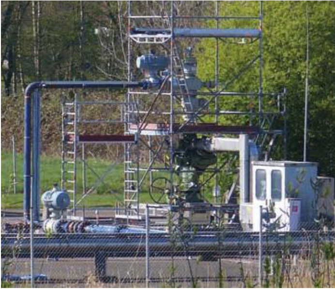
Gaskaverne L203 mit Vorrichtung zur Flutung. Die blaue Rohrleitung ist mit der Wasserpumpe verbunden. (Foto: N.Kück, April 2021)
